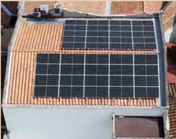
Imagen 30. Paneles solares de COOPEVIAN sede Medellín.
